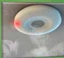
DETECCIÓN Y EXTINCIÓN DE INCENDIOS
